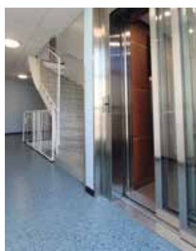
Lift naast het trappenhuis Elevator installed
