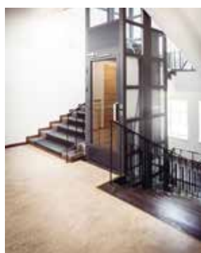
Lift in het trappenhuis
